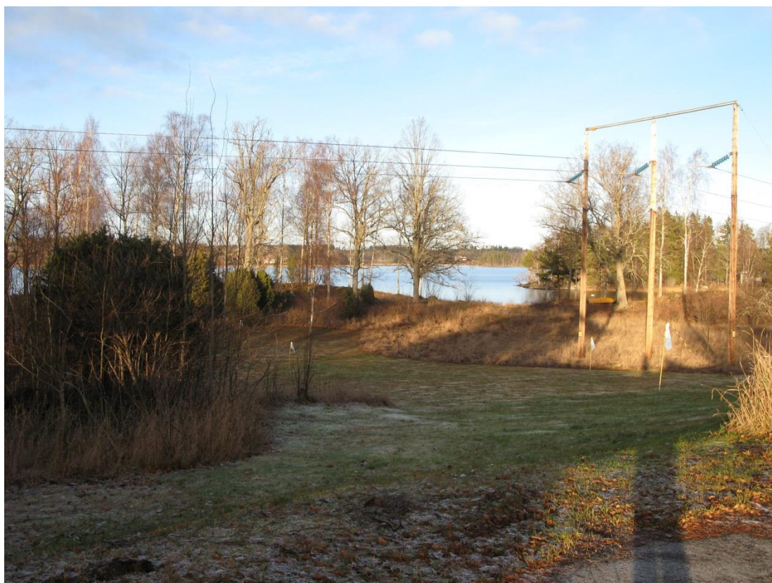
Kraftledning 40 kV längs Orrhammaren
